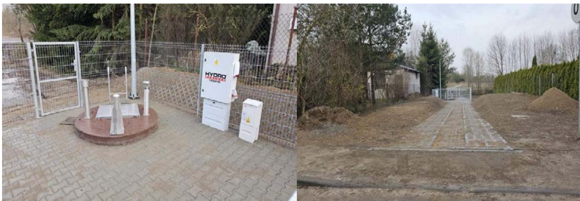
Hydrofornia ul. Dworcowa w Dąbrównie.
